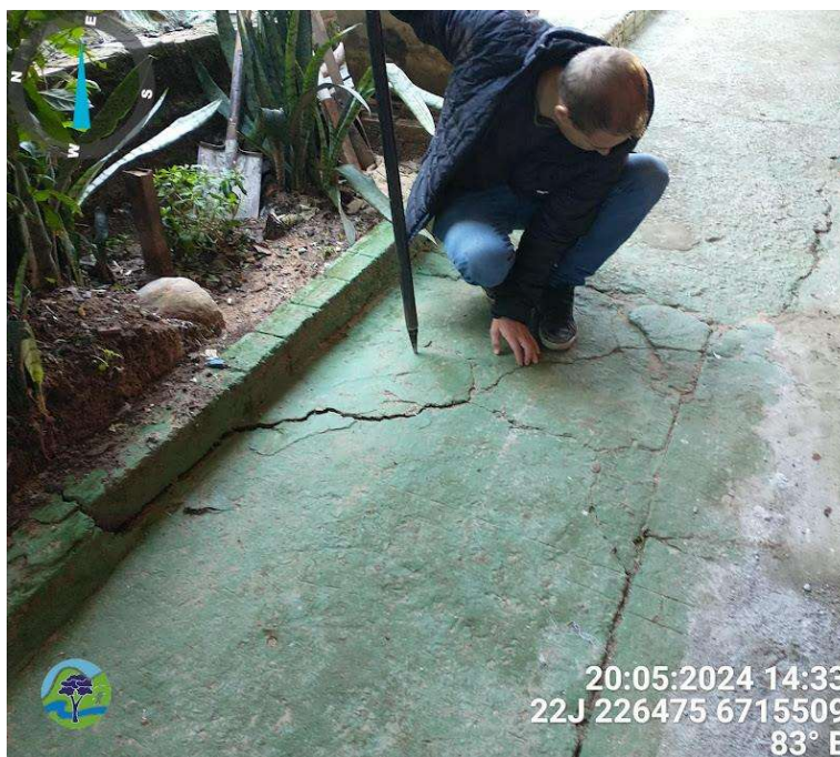
Figura 6 - Fissuras no piso que surgiram após o último evento de chuva intensa.
