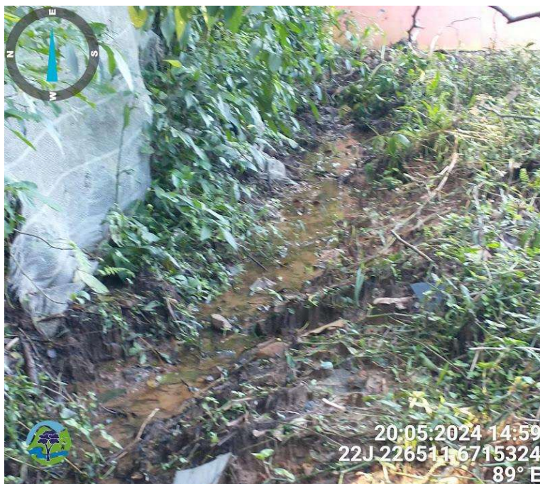
Figura 4 – Água corrente com origem no solo abaixo da casa. Ao fundo, é possível ver nova rachadura na estrutura de alvenaria.
