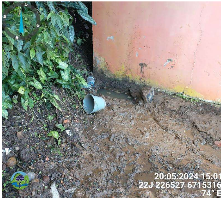
Figura 3 – Considerável quantidade de água exfiltrando do solo abaixo da casa.
