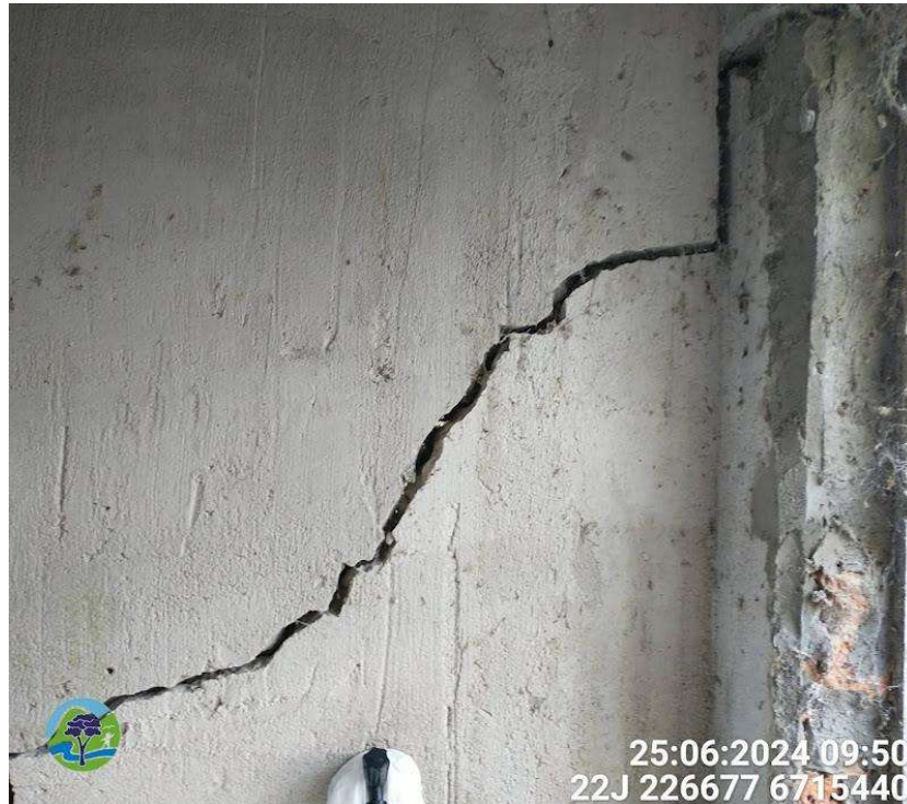
Figura 15 – Edificação nos fundos do endereço Rua das Marcelas 981. Segundo o morador do local, a rachadura aumentou significativamente durante os eventos chuvosos de maio de 2024.
