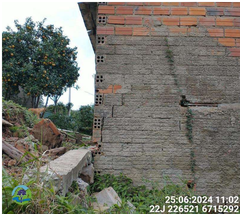
Figura 11 – Rachadura na Parede de casa na Rua Agudo nº 103.
