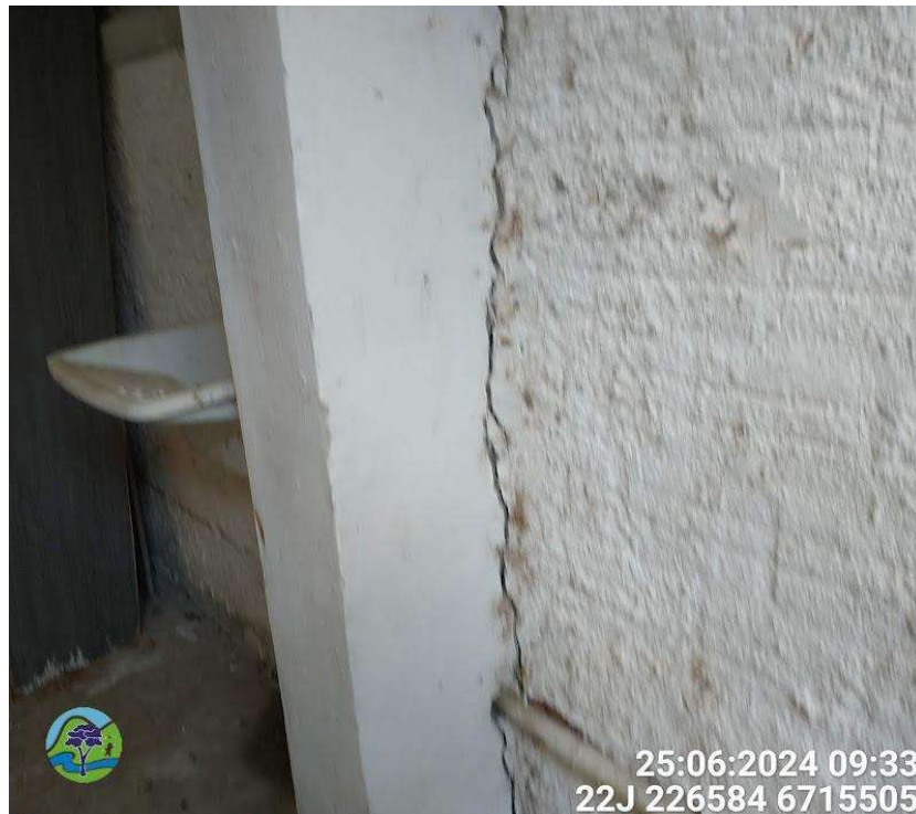
Figura 17 - Rachadura recente Junto ao pilar de sustentação do sobrado aos fundos do nº 226 da Rua das Marcelas.
