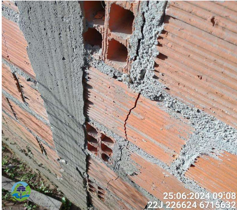
Figura 3 - Trinca em alvenaria de casa situada na Rua das Marcelas, a nordeste da Vila Santa Tereza.
