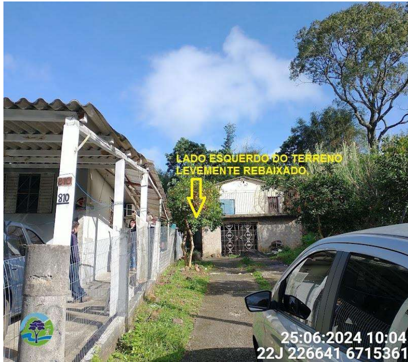
Figura 5 – Lado esquerdo do terreno da Rua das Marcelas nº 820, apresentando leve rebaixamento, indicando possível degrau de abatimento.
