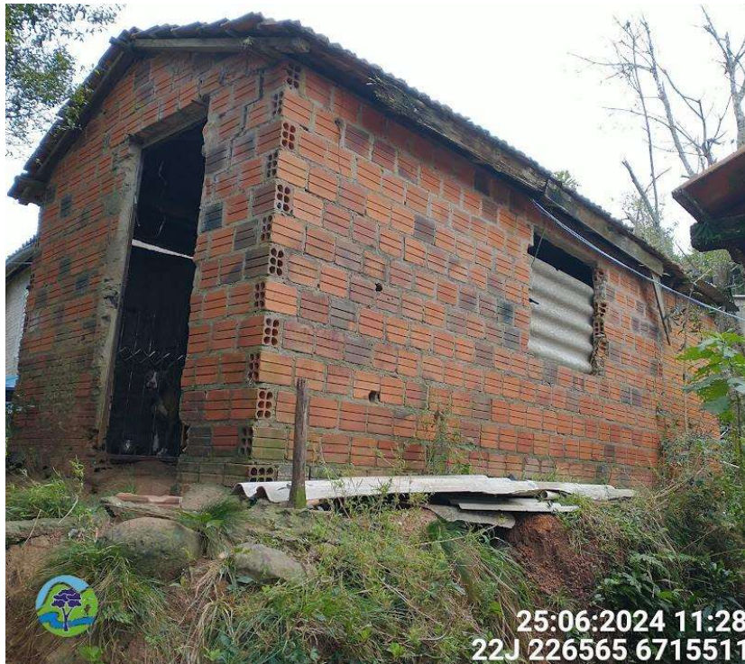
Figura 19 – Edificação na Rua Miraguai, coordenada UTM 22J 226558mE/6715514mS. A mesma está situada junto à corte subvertical no terreno e apresenta várias rachaduras. Caso venha a colapsar, poderá atingir a casa ao lado.
