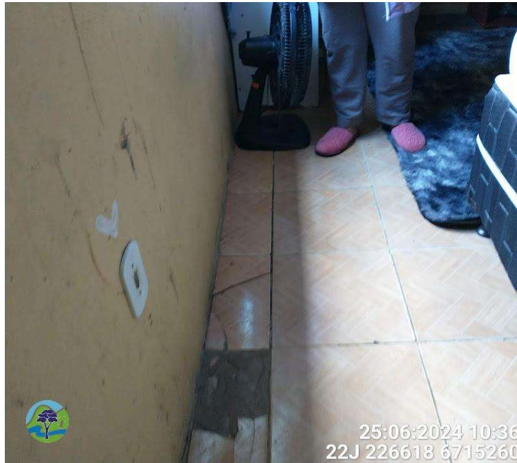
Figura 12 – Rachadura com leve soerguimento no piso da casa da Rua Agudo nº 32, que, segundo a moradora, surgiu após as chuvas torrenciais de maio de 2024.
