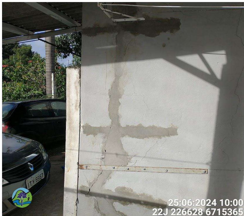
Figura 6 – Rachadura recente nas paredes de casa na Rua das Marcelas, nº 810. Nota-se que as rachaduras ocorreram após a execução de reparos na alvenaria, o que indica a continuidade da movimentação.
