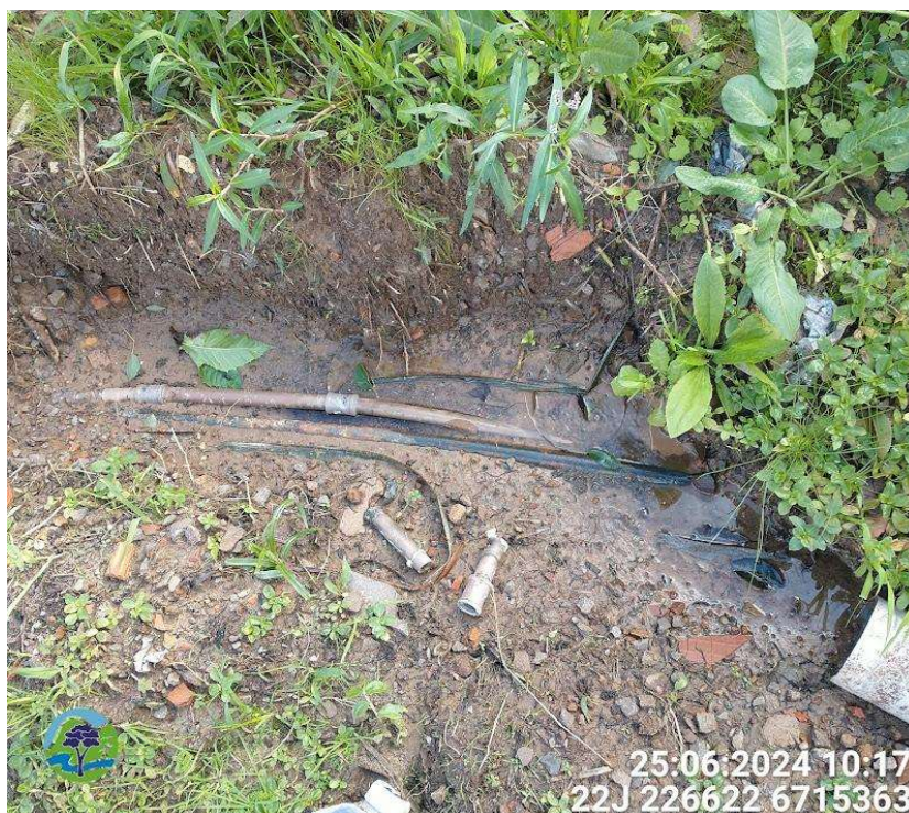
Figura 8 – Tubulação emendada na casa da Rua das Marcelas 820, devido a rompimento ocasionado pela movimentação do terreno.
