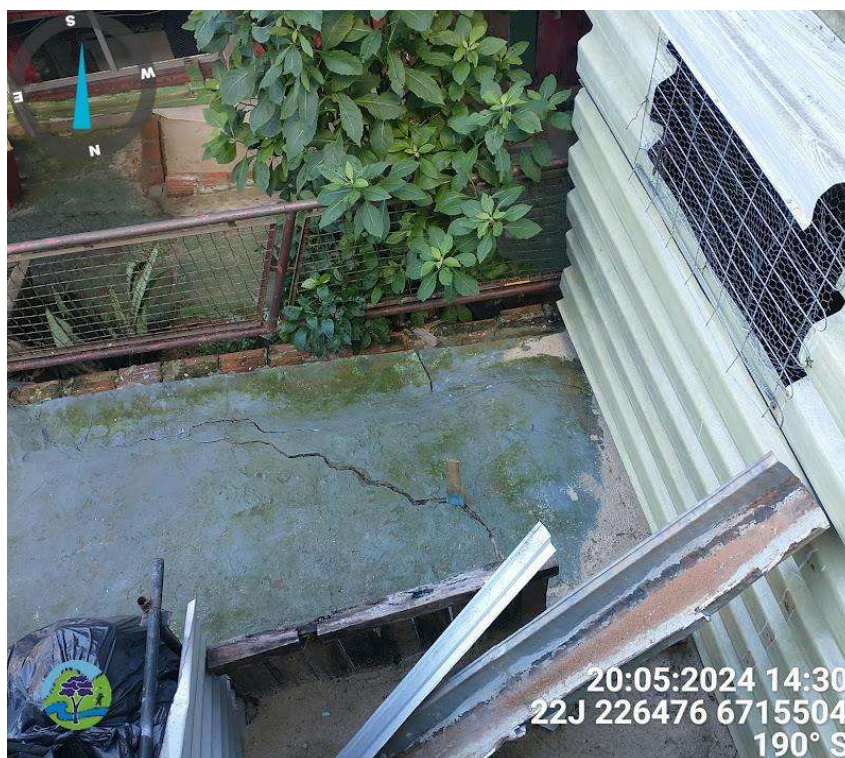
Figura 7 - Fissuras no piso que surgiram após o último evento de chuva intensa, indicando ruptura do solo.
