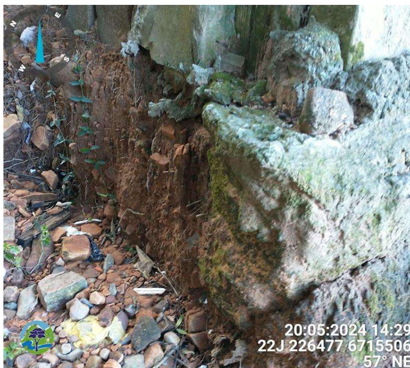
Figura 8 - Solo da lateral e da base da sapata erodido.
