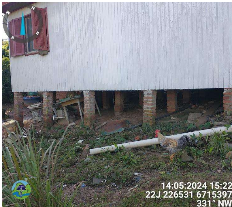
Figura 4 - Casa localizada na região da crista do escorregamento, com pilares inclinados devido à movimentação do solo.
