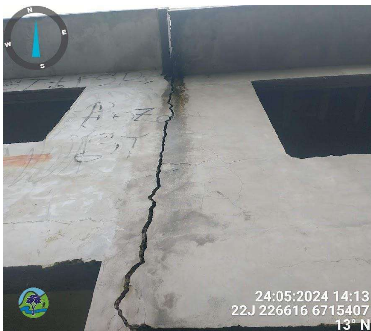
Figura 3 - Rachadura na estrutura do prédio.
