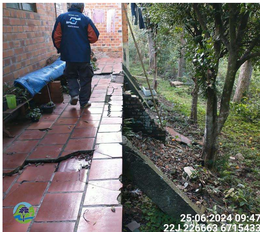
Figura 16 – Rachaduras e rebaixamento do piso lateral da casa da Rua das Marcelas 981, indicando o carreamento de solo abaixo da estrutura em função do fluxo de água. Nota-se que já foram construídas estruturas de concreto com a intenção de impedir a movimentação da edificação.
