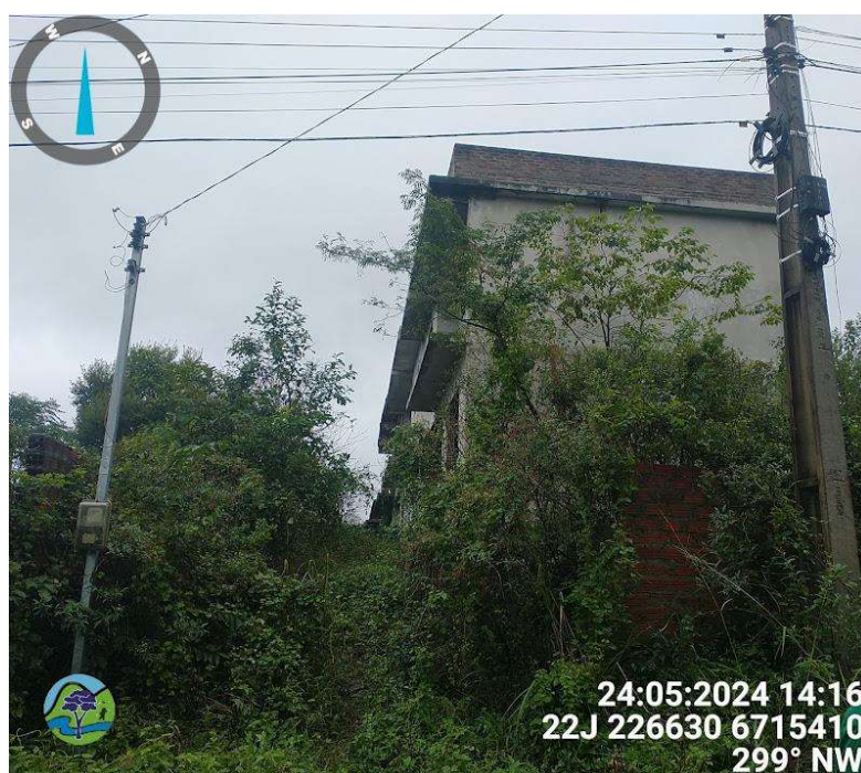
Figura 1 - Construção abandonada com danos estruturais, localizada na Rua das Marcelas.
