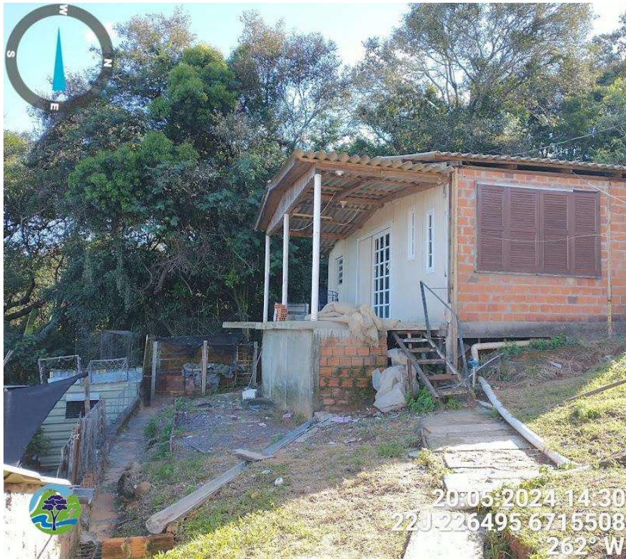
Figura 9 – Casa com fundações fragilizadas, situada próxima a zona com indícios de movimento de massa que surgiram após as últimas chuvas.
