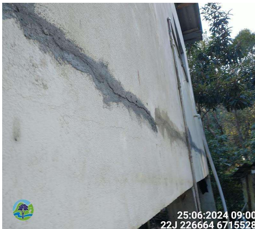
Figura 4 - Trinca em alvenaria casa situada aos fundos do endereço Rua das Marcelas nº 983.
