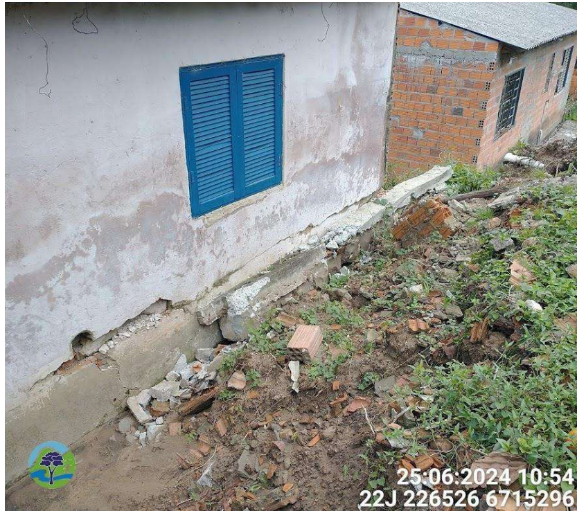
Figura 10 – Local da queda de muro na Rua Agudo nº 103.. Na ocasião o proprietário já havia recolhido a maior parte do entulho. Nota-se também o comprometimento da estrutura da casa, ao lado.
