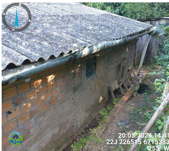
Figura 2 – Rachadura recente em estrutura de alvenaria.
