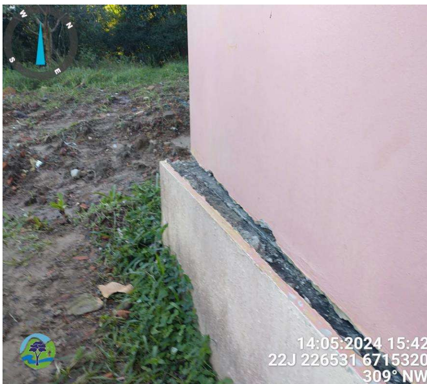
Figura 7 - Deslocamento horizontal da viga baldrame,
