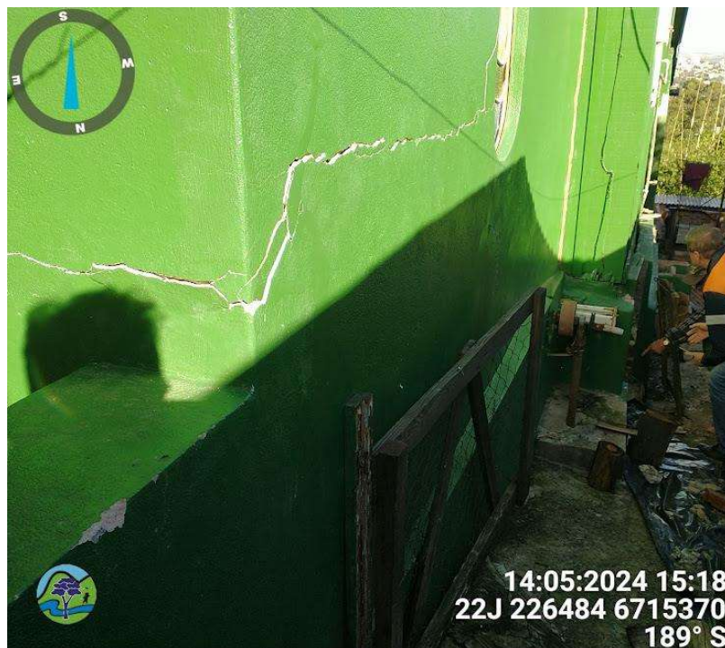
Figura 5 - Casa localizada mais danificada, com diversos danos estruturais e relatos de barulhos na estrutura no dia da vistoria.
