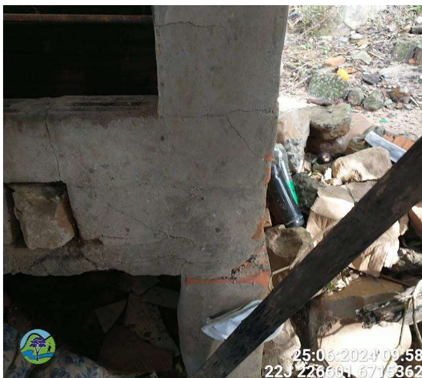
Figura 7 – Rachadura recente nas em estrutura de alvenaria na Rua das Marcelas, nº 820.
