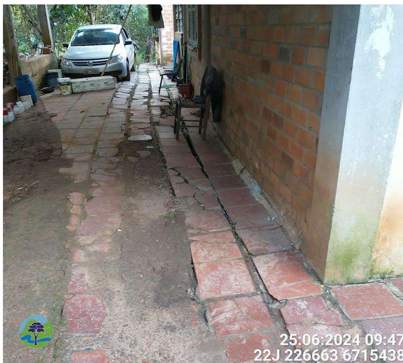
Figura 14 – Movimentação do terreno percebida no piso da garagem da casa da Rua das Marcelas 981, que apresenta grandes rachaduras. Segundo o morador, em dias de chuvas torrenciais, a água cumula no local e infiltra com facilidade nas rachaduras.
