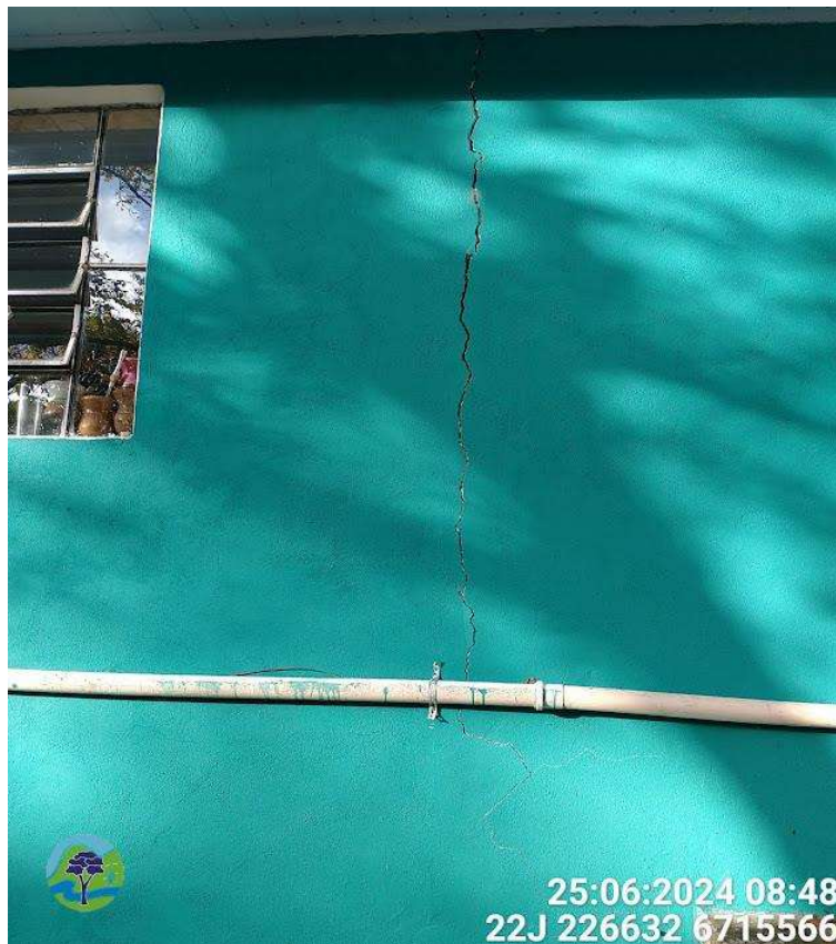
Figura 1 - Rachadura em parede de casa situada na Rua das Marcelas, a nordeste da Vila Santa Tereza, que segundo morador do local, teria ocorrido após as chuvas torrenciais de maio de 2024.
