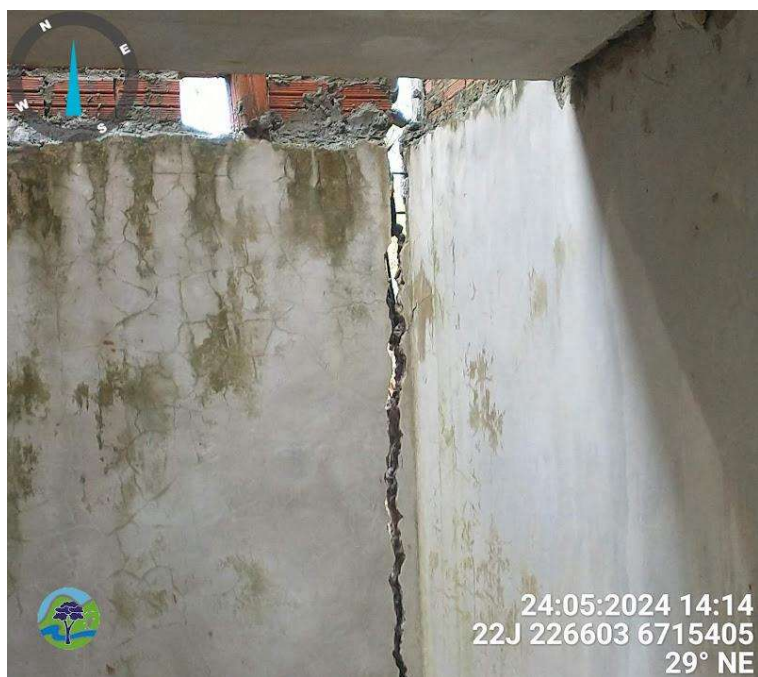
Figura 2 – Rachadura na estrutura do prédio.
