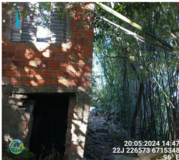
Figura 1 - Estrutura de alvenaria deformada e com diversas rachaduras.
