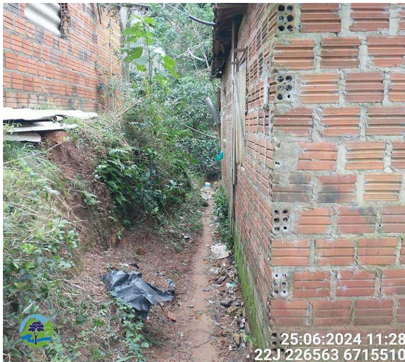
Figura 20 – Edificação com risco de desabamento (a esquerda da imagem), que pode provocar danos a casa ao lado (a direita da imagem) .
