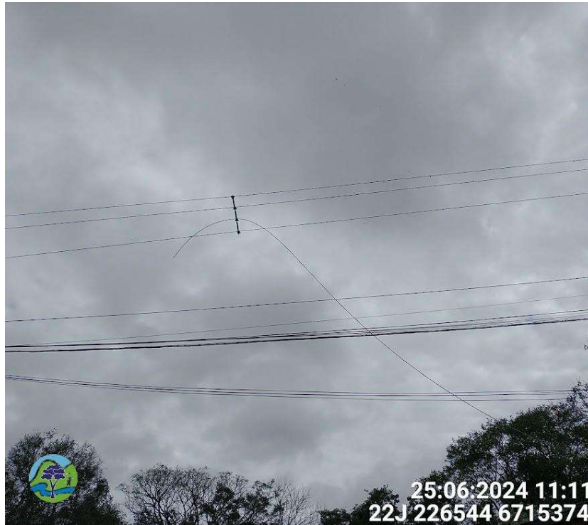
Figura 9 – Fio da rede elétrica rompido. Nota-se também que os fios que não romperam estão bastante tensionados.
