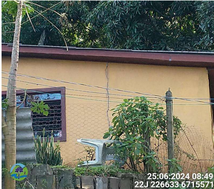
Figura 2 - Rachadura em parede de casa situada na Rua das Marcelas, a nordeste da Vila Santa Tereza,
