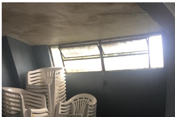
Figura 46 Laje da mesma sala, onde se encontra apoiado o reservatório, com manchas visíveis de umidade. Fonte: Acervo ArqConjunta (2017).
