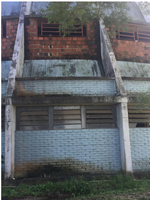
Figura 63 Presença de limo na alvenaria de vedação em tijolos. Fonte: Acervo ArqConjunta (2017).
