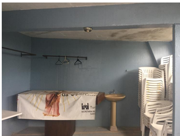
Figura 19 Espaço utilizado como Sacristia, onde é possível perceber as marcas das formas de concreto, tanto nas paredes como no teto. Fonte: Acervo ArqConjunta (2017).
