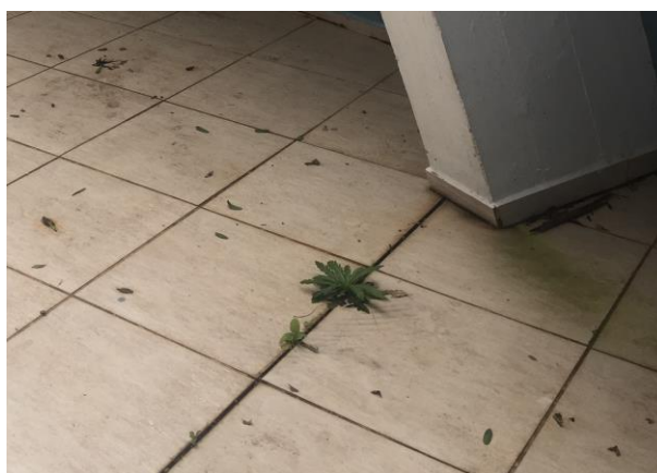
Figura 49 Revestimento cerâmico ainda do mesmo pavimento apresentando limo e presença de flora. Fonte: Acervo ArqConjunta (2017).
