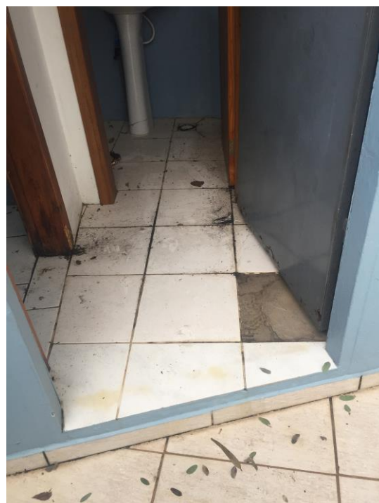
Figura 22 Acesso aos sanitários com pequeno desnível e falhas na pavimentação cerâmica. Fonte: Acervo ArqConjunta (2017).
