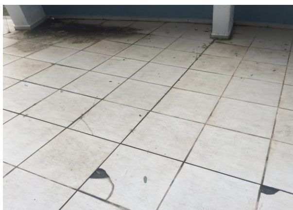
Figura 48 Revestimento cerâmico do mesmo pavimento com rejunte desgastados, apresentando quebras e trincas. É possível identificar juntas de dilatação. Fonte: Acervo ArqConjunta (2017).
