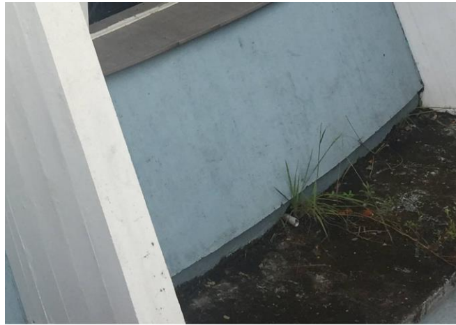
Figura 62 Deposição de sujidades e presença de flora. Fonte: Acervo ArqConjunta (2017).
