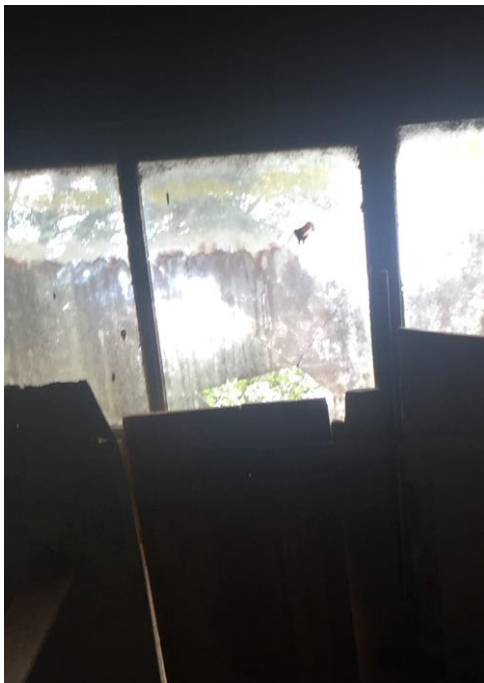
Figura 53 Esquadria original, alocada no pavimento intermediário, disposta de forma inclinada, deposição de sujeiras e vidros quebrados. Fonte: Acervo ArqConjunta (2017).
