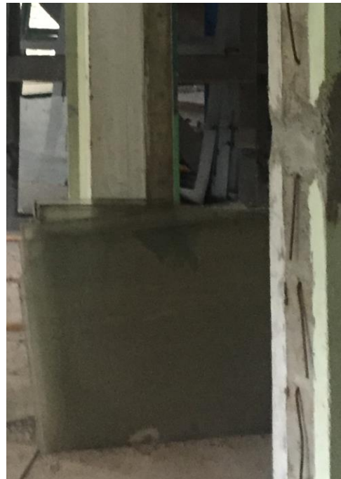
Figura 54 Também no pavimento intermediário, pilares inacabados com armaduras de amarração expostas. Fonte: Acervo ArqConjunta (2017).
