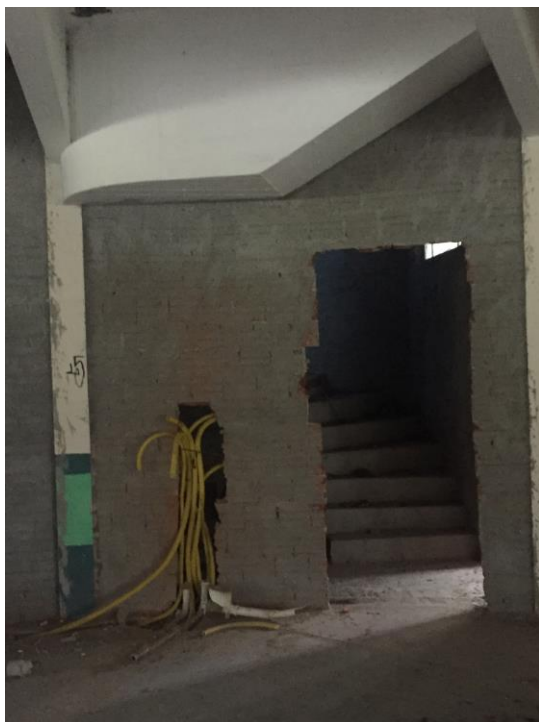
Figura 31 Chegada da escadaria de acesso ao pavimento térreo, conduites inacabados. Fonte: Acervo ArqConjunta (2017).
