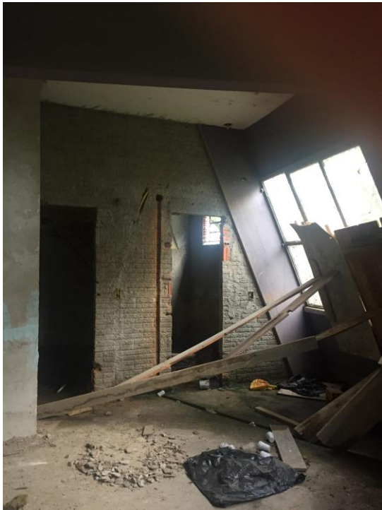
Figura 29 Paredes de compartimentação interna em osso - com tijolos de seis furos apenas chapiscados. Fonte: Acervo ArqConjunta (2017).
