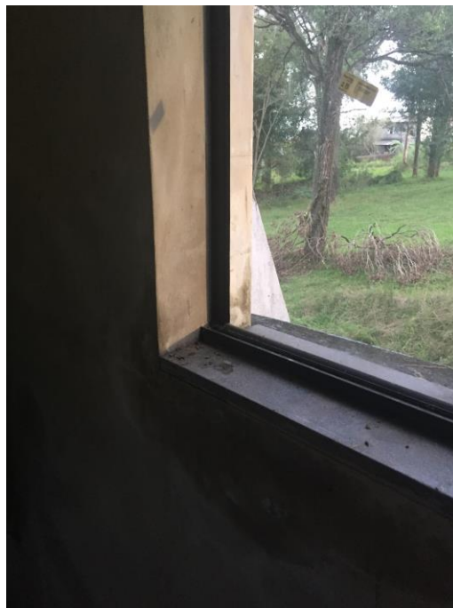
Figura 61 Esquadria com sinais de infiltração. Fonte: Acervo ArqConjunta (2017).
