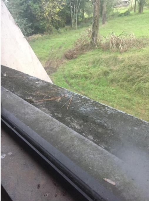
Figura 59 Peitoril com marcas da retirada da esquadria original. Fonte: Acervo ArqConjunta (2017).
