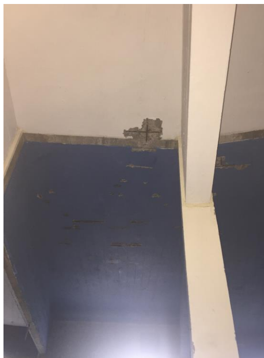
Figura 55 Laje de forro do pavimento intermediário com perda de cobertura da armadura, possivelmente umidade proveniente do piso adjacente provocando a carbonatação da estrutura de concreto e sinais de oxidação da armadura. Fonte: Acervo ArqConjunta (2017).
