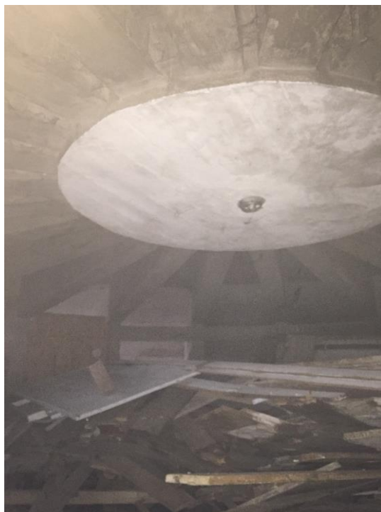
Figura 39 Ligação superior do vigamento que acontece no pavimento inferior. Fonte: Acervo ArqConjunta (2017).
