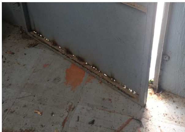
Figura 45 Porta da sala utilizada como sacristia, chapa metálica em processo de corrosão acentuado. Fonte: Acervo ArqConjunta (2017).
