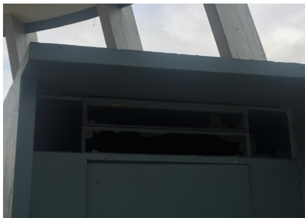
Figura 44 Porta que conduz ao pavimento intermediário, bandeira fixa superior com vidros quebrados. Fonte: Acervo ArqConjunta (2017).
