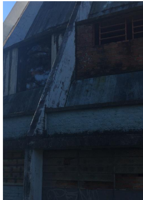
Figura 64 Ausência de revestimento na alvenaria, esquadrias em metal já com sinais de ferrugem. Fonte: Acervo ArqConjunta (2017).
