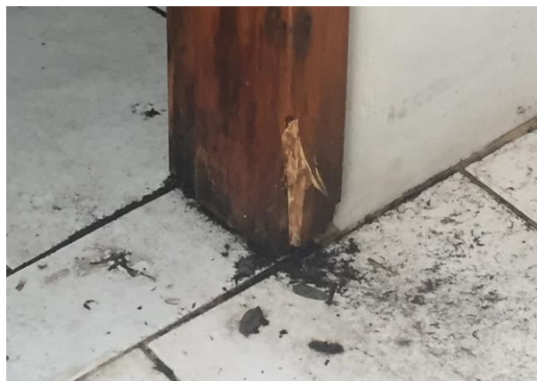
Figura 52 Marco e guarnição das portas em madeira (sanitários do pavimento térreo) deterioradas. Fonte: Acervo ArqConjunta (2017).
