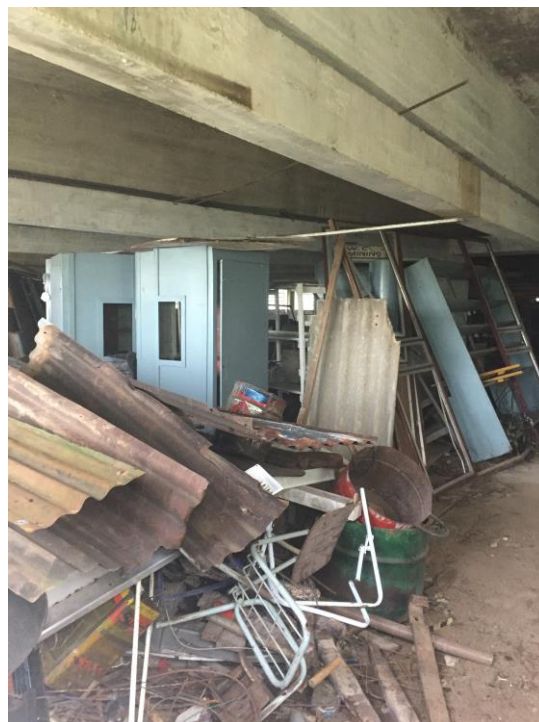
Figura 35 Espaço sendo amplamente utilizado como depósito. Fonte: Acervo ArqConjunta (2017).
