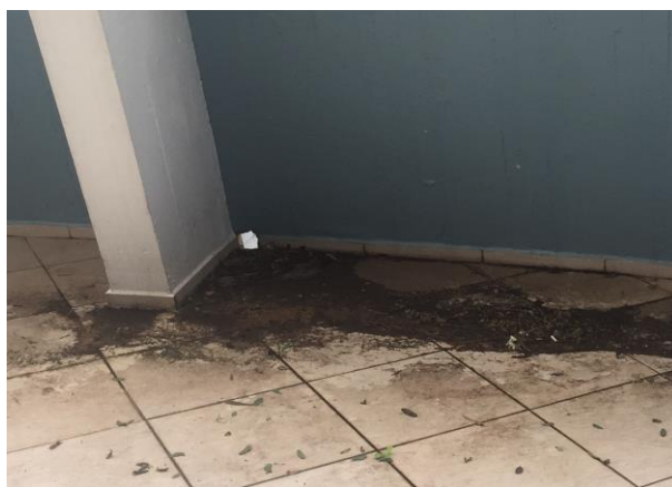
Figura 47 Piso do pavimento térreo, onde se verifica furação na parede de concreto para possibilitar escoamento das águas, acúmulo de sujeiras. Fonte: Acervo ArqConjunta (2017).
