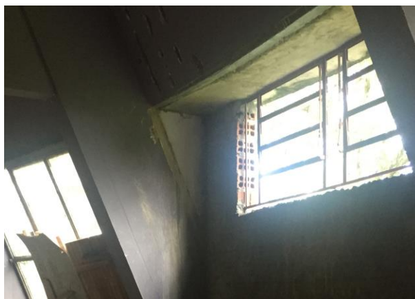
Figura 58 Ainda no pavimento Intermediário é possível perceber a oxidação das esquadrias de ferro. Fonte: Acervo ArqConjunta (2017).
