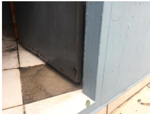
Figura 51 Também acesso aos sanitários do pavimento térreo, revestimento de piso faltante, porta em processo de corrosão. Fonte: Acervo ArqConjunta (2017).
