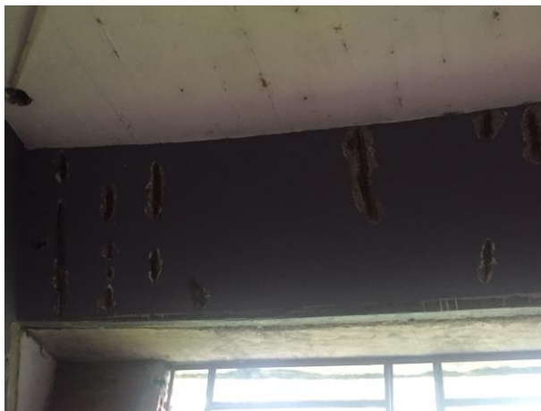
Figura 57 Mesmos sinais vistos nas duas figuras anteriores, porém aqui apresentado na viga. Fonte: Acervo ArqConjunta (2017).
