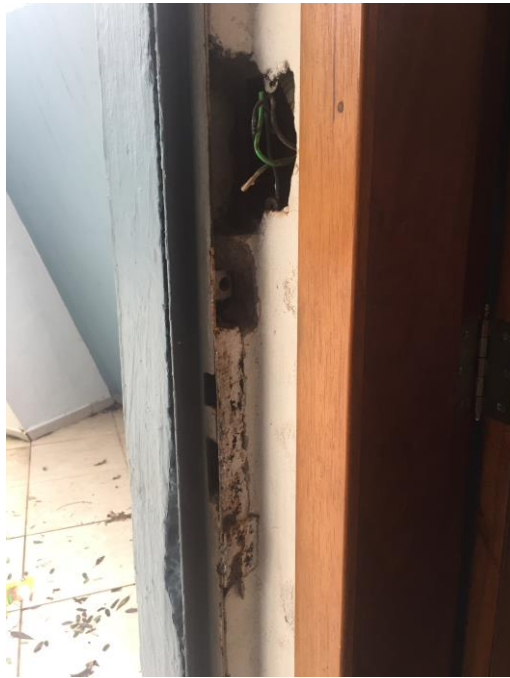
Figura 50 Acesso aos sanitários com elétrica inacabada, reboco com rachaduras, sinais de umidade claros visualizados pela oxidação do marco da esquadria. Fonte: Acervo ArqConjunta (2017).
