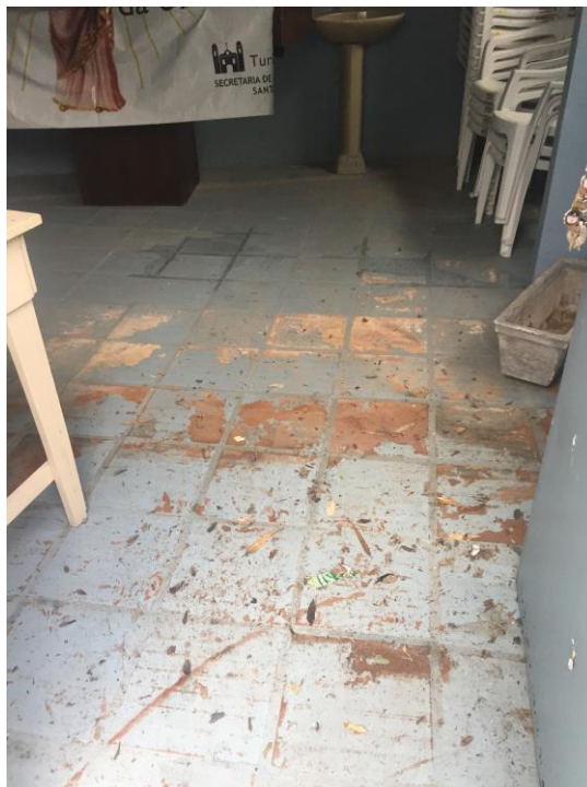
Figura 20 Na mesma sala, o piso foi executado com lajotas que provavelmente foram pintadas para encobrir imperfeições. Os desgastes são visíveis tanto na pintura quanto na cerâmica de revestimento. Fonte: Acervo ArqConjunta (2017).
