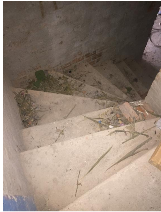
Figura 27 Escadaria com piso cimentado, ausência de revestimento e corrimãos. Fonte: Acervo ArqConjunta (2017).
