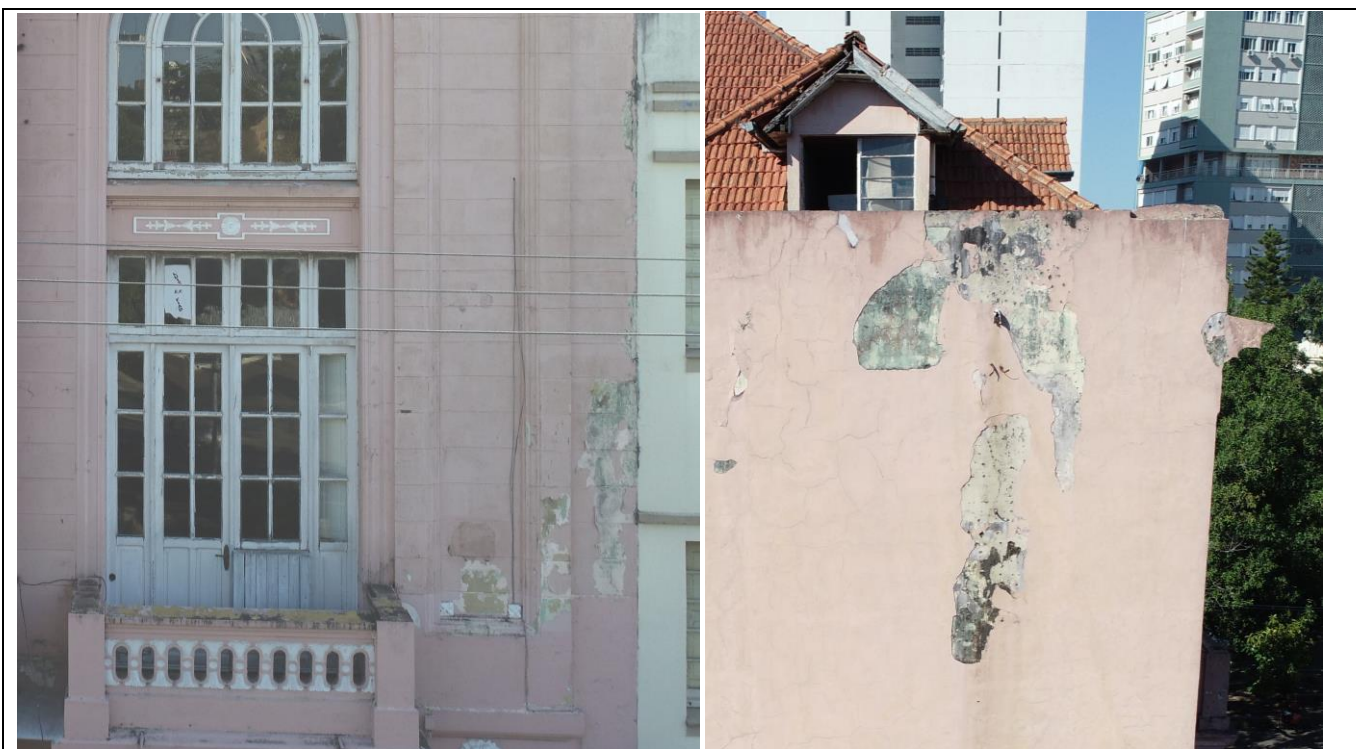
Figuras posição fachada sul E-H/7-8 e fachada norte J-M/2-4
