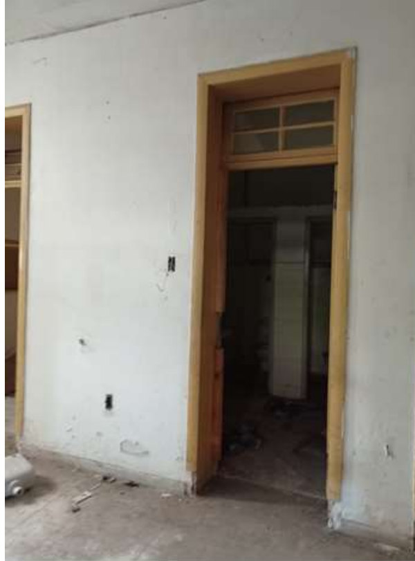
Figura 139: Porta PE6b, localizada na circulação horizontal do primeiro pavimento. Fonte: SCHARLAU, M.L (2022).
