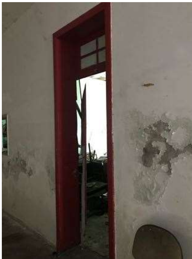
Figura 182: Umidade na parede da circulação horizontal do segundo pavimento. Fonte: FROS, C.S (2021).
