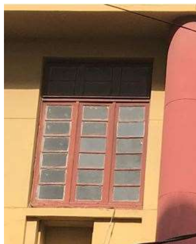
Figura 134: Janela JE6c, localizada no pavimento superior da fachada voltada à Rua Roque Callage. Fonte: FROS, C.S (2022).
