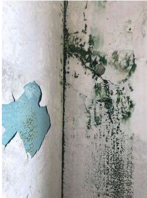
Figura 180: Imagem mais próxima, apresentando a umidade, na interseção entre a parede externa e a interna. Fonte: FROS, C.S (2021).
