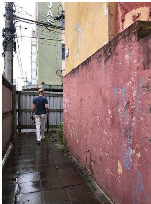
Figura 153: Presença de patologias na base da edificação. Registro da visita de Biólogo, para conhecer o imóvel. Fonte: FROS, C.S (2021).
