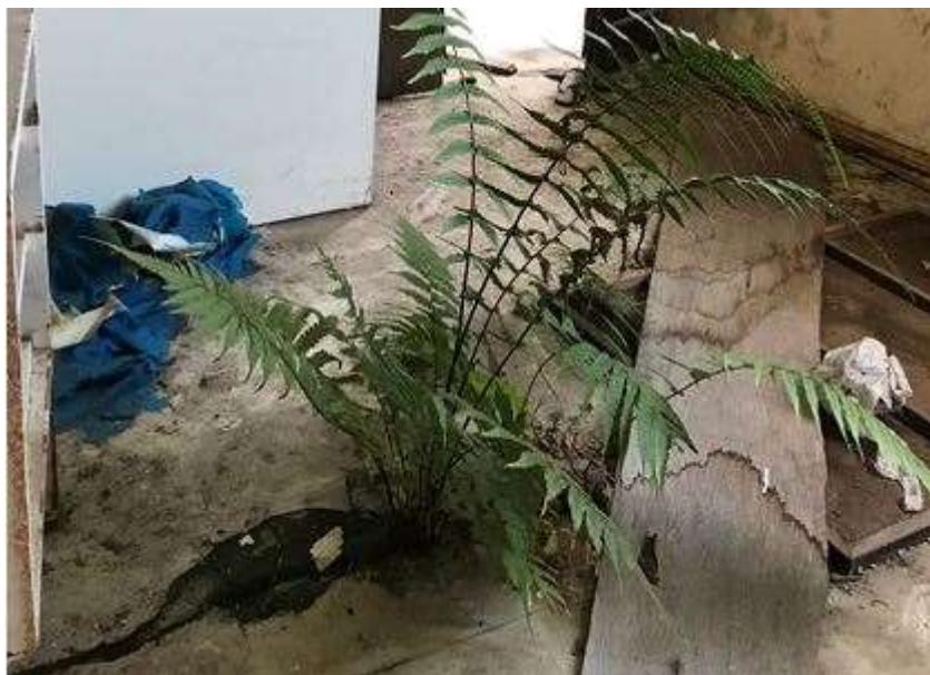
Figura 174: Rachadura na laje, com presença de vegetação. Fonte: FROS, C.S (2021).
