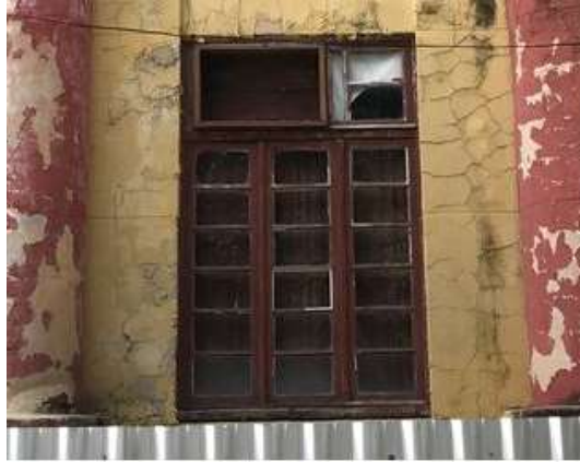
Figura 109: Janela de madeira com bandeirola, três folhas e caixilhos com vidro. Identificada em desenho técnico como JE1a. Voltada à Praça Saldanha Marinho, vê-se recorte em bandeirola, devido à instalação de ar-condicionado. Fonte: FROS, C.S (2022).
