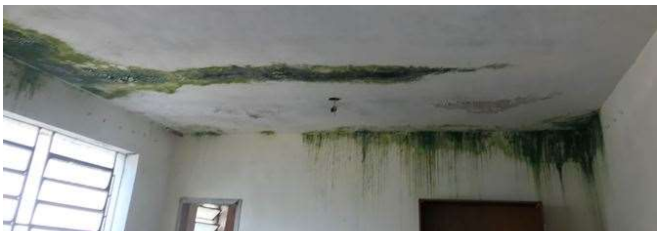
Figura 185: Desde o terceiro pavimento, vê-se umidade e consequentemente presença de microrganismos. Fonte: FROS, C.S (2021).
