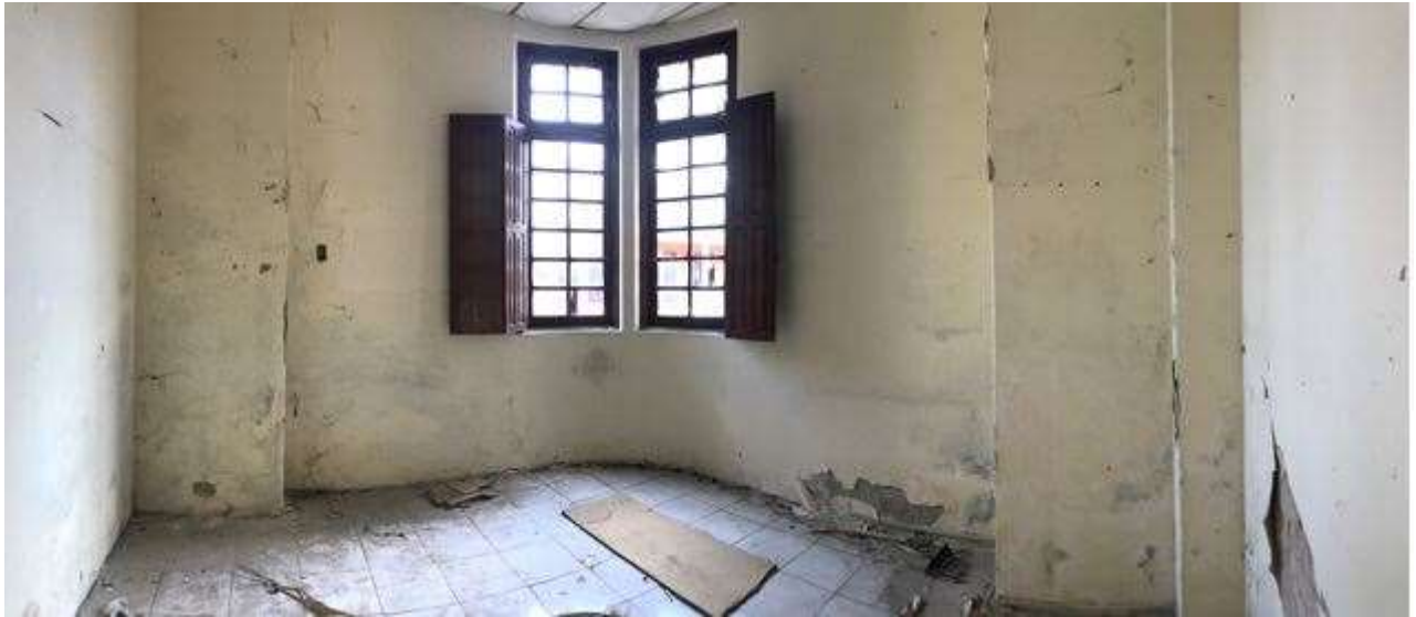
Figura 162: Marcas de umidade vistas no interior da edificação, referente a paredes periféricas à edificação. Fonte: FROS, C.S (2021).
