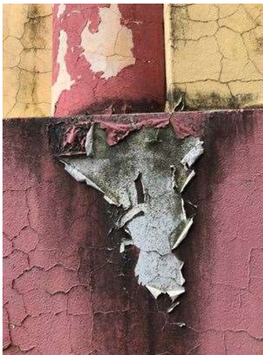
Figura 155: As fachadas apresentam a pintura descascada, assim como presença de microrganismos. Fonte: FROS, C.S (2021).
