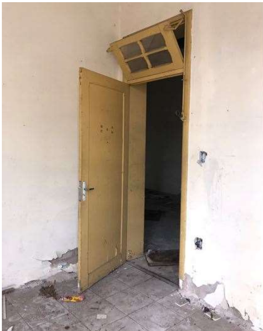
Figura 163: Porta interna necessitando restauro devido à falta de manutenção. Destacasse nas laterais da mesma, o comprometimento do reboco devido a umidade ascendente. Fonte: FROS, C.S (2021).
