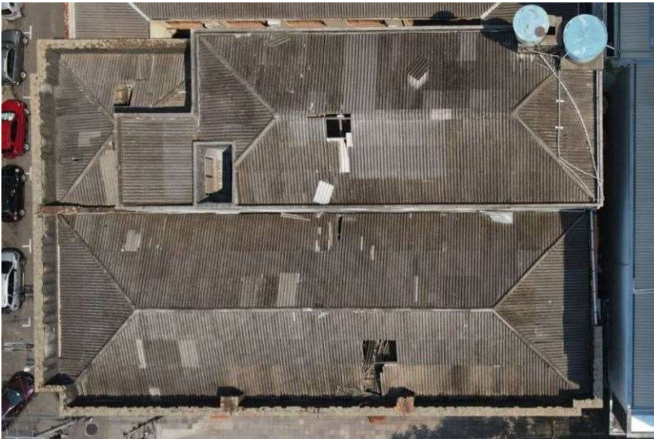
Figura 152: Foto aérea apresentado da cobertura da edificação, apresentado áreas sem telhas. Fonte: Empresa Lumenk, 2022.
