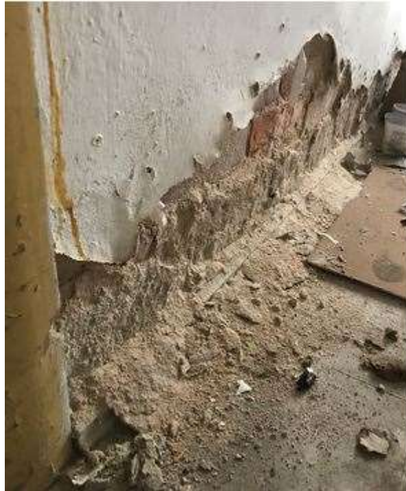
Figura 164: Base de parede interna no primeiro pavimento, com reboco comprometido. Fonte: FROS, C.S (2021).
