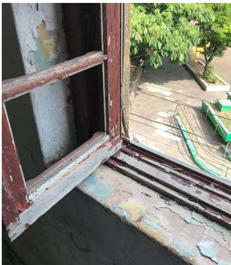
Figura 175: Precariedade das esquadrias devido à falta de manutenção. Fonte: FROS, C.S (2021).
