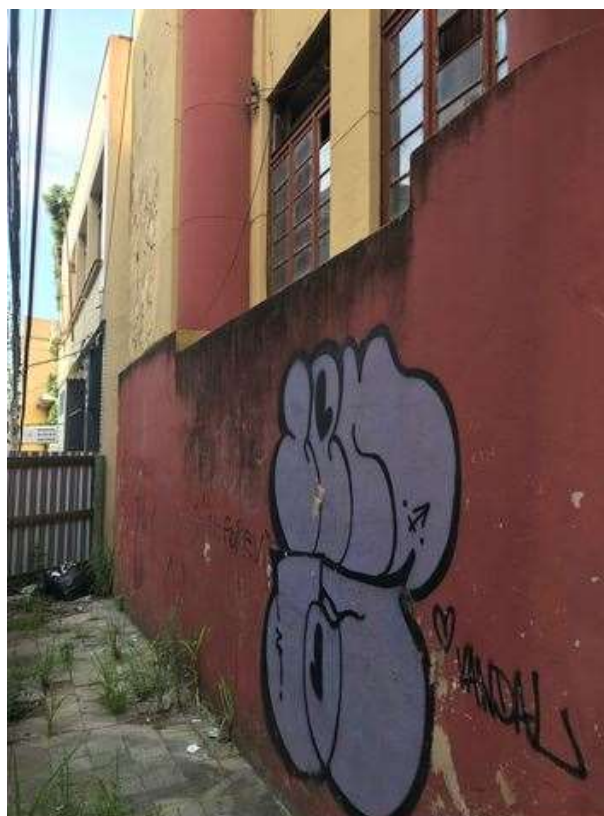
Figura 154: Base da edificação com pichações. Fonte: FROS, C.S (2022).
