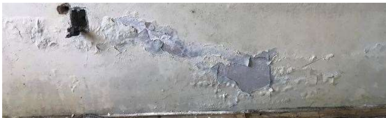
Figura 173: Internamente, há ambientes com presença de sais devido à umidade na base das paredes. Fonte: FROS, C.S (2021).
