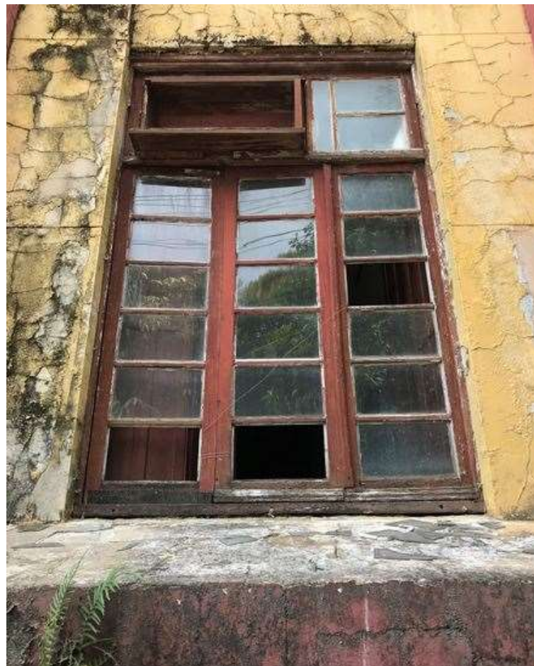
Figura 159: Situação precária de uma das esquadrias com estado heterogêneo devido a recorte de bandeirola para instalação de antigo condicionador de ar. Fonte: FROS, C.S (2021).
