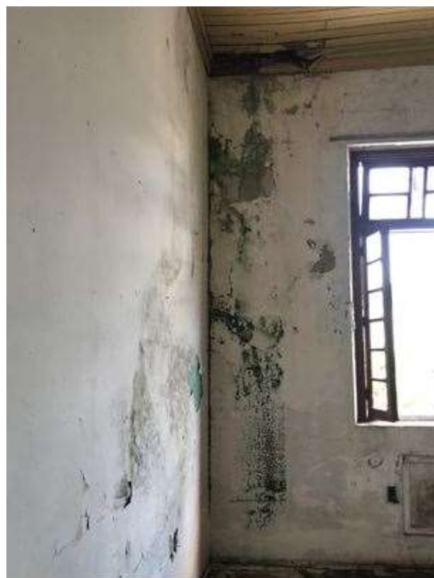
Figura 179: Marcas de umidade vistas no interior da edificação, referente a parede da fachada principal do imóvel. Fonte: FROS, C.S (2021).
