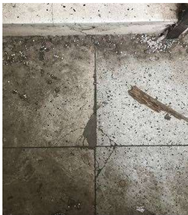
Figura 167: Patamar da escada com fissuras e evidência de adição de novo material como intervenção posterior. Fonte: FROS, C.S (2021).
