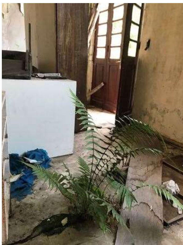
Figura 76: Samambaia em rachadura da laje. Fonte: FROS, C.S (2022).
