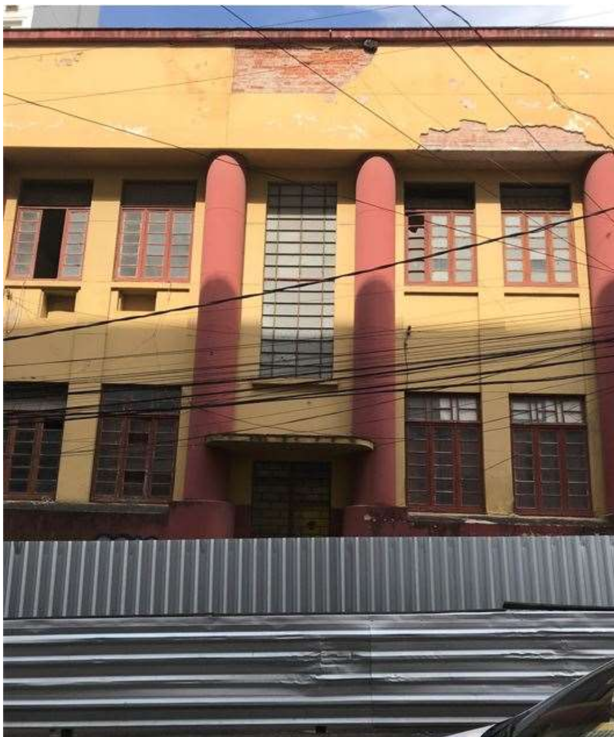
Figura 126: Fachada voltada à Rua Roque Callage. No peitoril de duas esquadrias, vê-se volumes subtraídos para a instalação de antigos condicionadores de ar. Fonte: FROS, C.S (2022).
