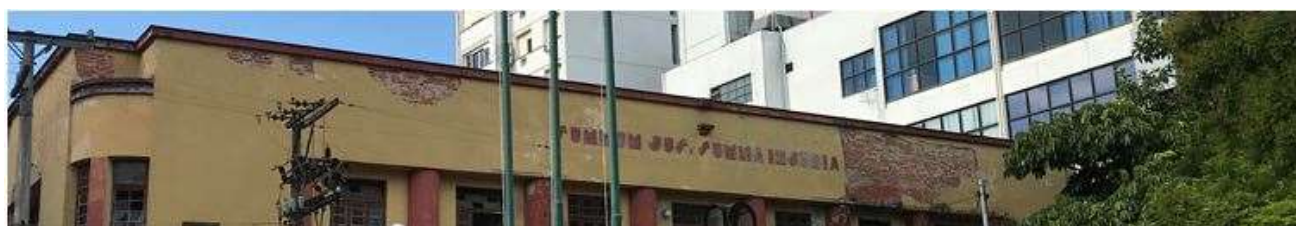
Figura 157: Na fachada voltada à Praça Saldanha Marinho, destacam-se, na platibanda, o desprendimento do reboco. Fonte: FROS, C.S (2021).
