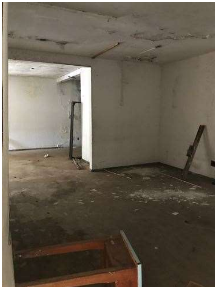
Figura 184: Presença de umidade tanto em parede como na laje superior, vista desde o terceiro pavimento. Fonte: FROS, C.S (2021).
