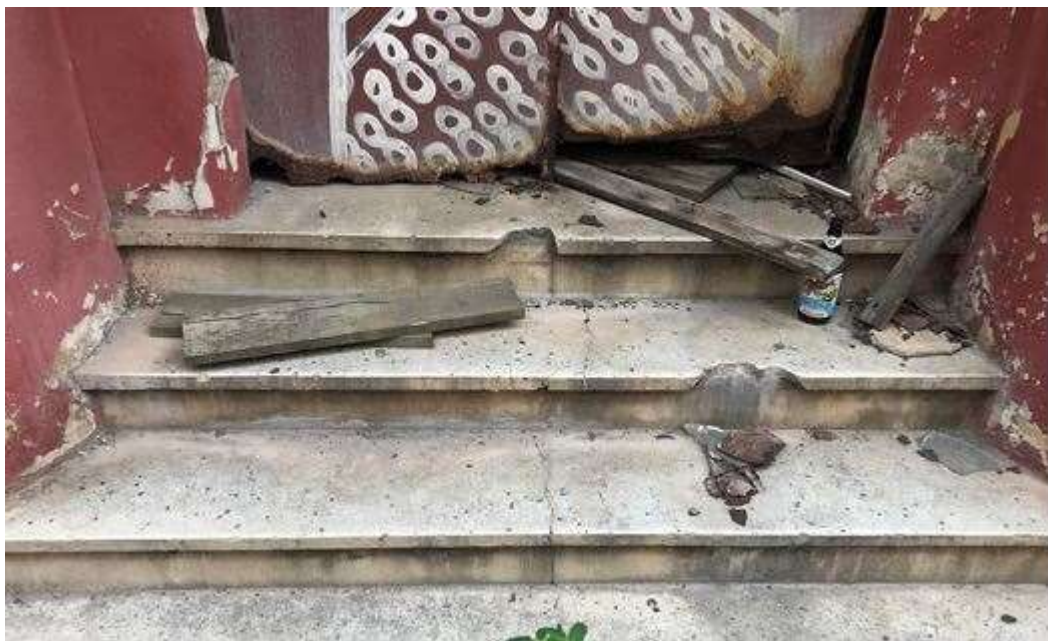
Figura 161: A base da porta, localizada na Rua Roque Callage encontrasse oxidada. Também, vê-se parte dos degraus, em mármore, danificados. Fonte: FROS, C.S (2021).
