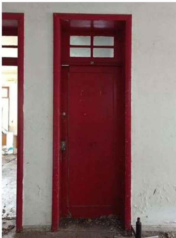
Figura 148: Porta PE9b, localizada na circulação horizontal do segundo pavimento. Fonte: SCHARLAU, M.L (2022).
