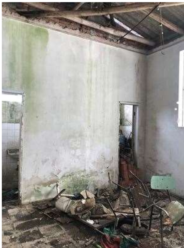
Figura 188: Umidade em ambiente do quarto pavimento. Fonte: FROS, C.S (2021).
