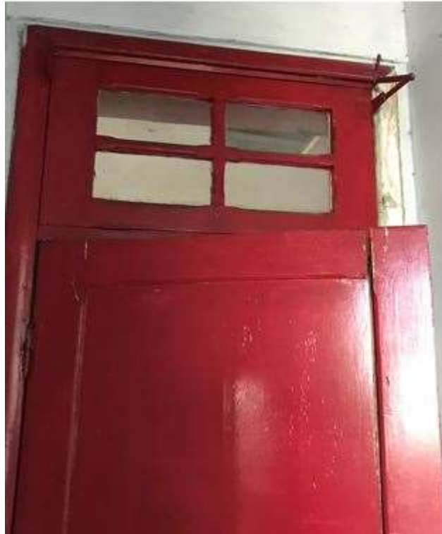
Figura 170: Porta e bandeirola danificadas no segundo pavimento. Fonte: FROS, C.S (2022).
