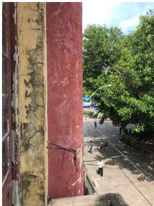
Figura 181: Pequenas fissuras na fachada e presença de microrganismos. Em primeiro plano, vê-se a situação precária da esquadria em madeira. Fonte: FROS, C.S (2021).
