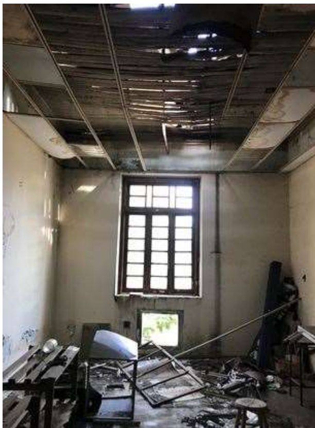
Figura 176: Falta de telhado, compromete o forro, causando umidade em ambiente do segundo pavimento. Fonte: FROS, C.S (2021).
