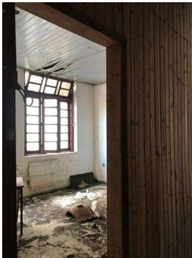
Figura 178: Telhado comprometido, causa umidade nos ambientes do segundo pavimento. Fonte: FROS, C.S (2021).
