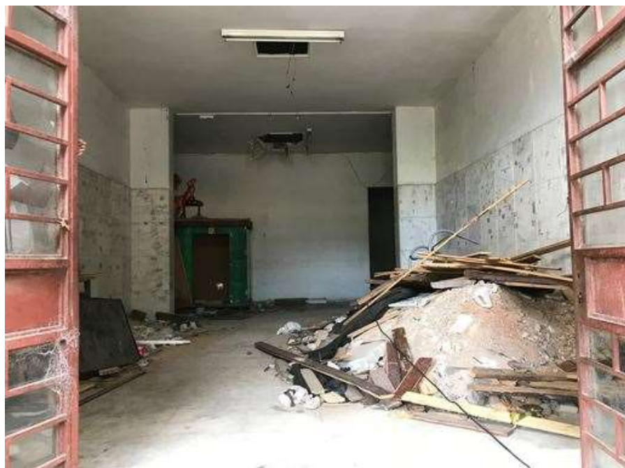
Figura 43: Hall de entrada. Fonte: FROS, C.S (2022).
