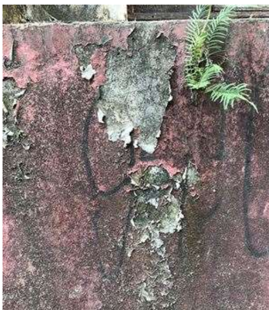
Figura 156: Presença de microrganismos, vegetação e pichações na base da edificação. Fonte: FROS, C.S (2021).
