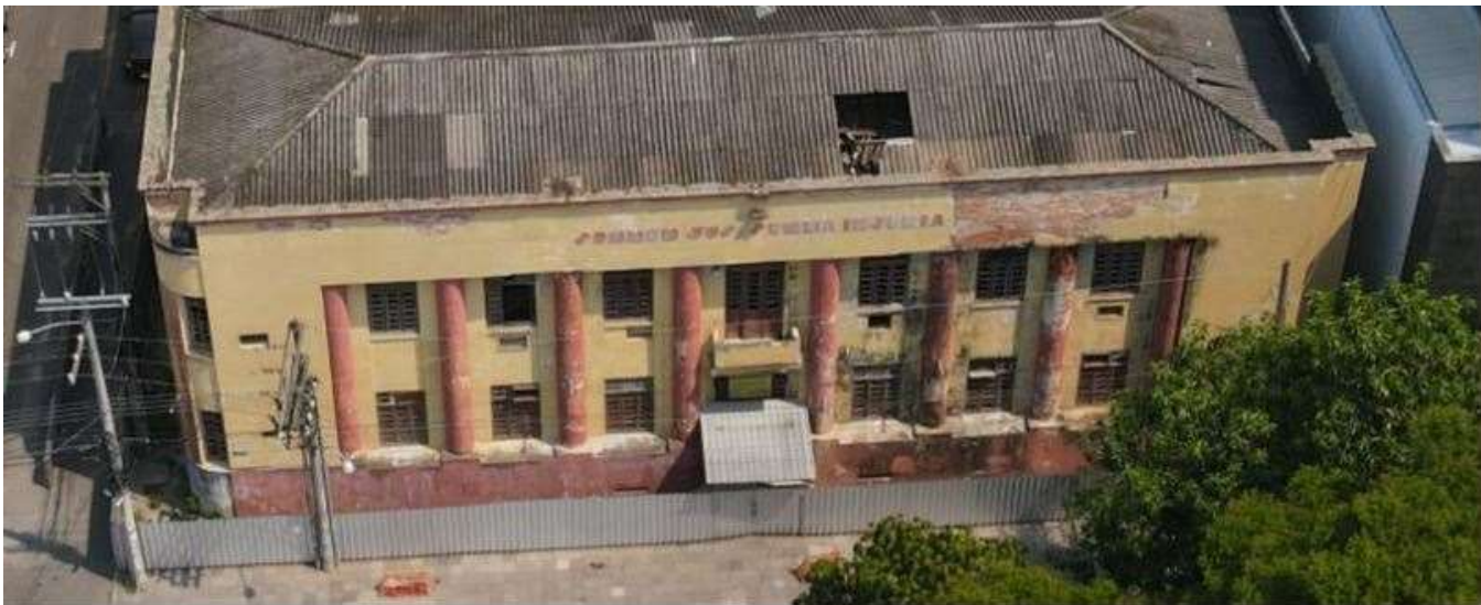
Figura 151: Foto aérea apresentado as patologias presentes na fachada principal da edificação. Fonte: Empresa Lumenk, 2022.
