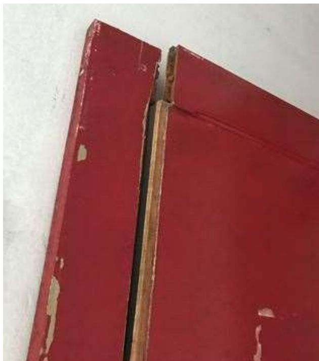
Figura 171: Porta danificada no segundo pavimento. Fonte: FROS, C.S (2022).
