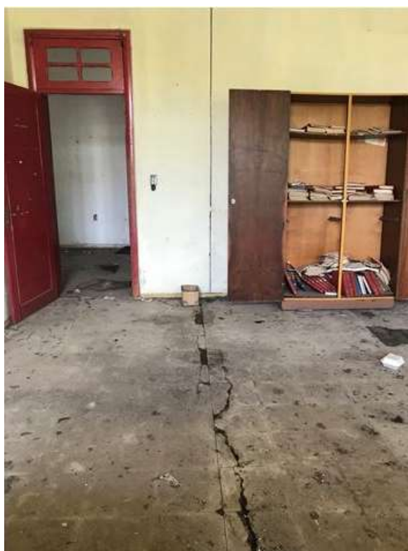
Figura 75: Ambiente voltado à Praça Saldanha Marinho. Destaca-se uma importante rachadura na laje, em direção a junta presente na parede. Aos fundos vê-se o corredor. Fonte: FROS, C.S (2022).
