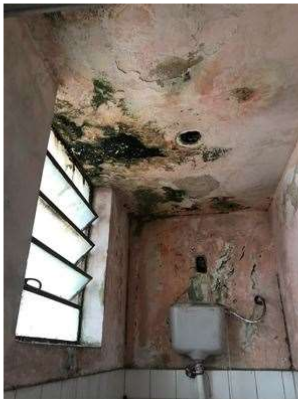
Figura 186: umidade e consequentemente presença de microrganismos em parede e laje. Fonte: FROS, C.S (2021).
