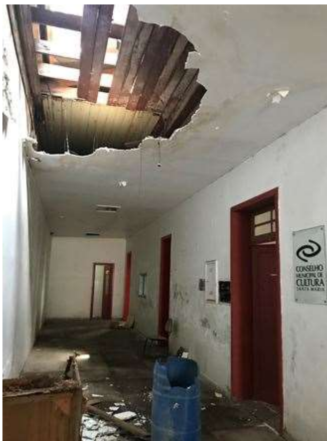
Figura 169: Desde a circulação horizontal do segundo pavimento, vê-se as consequências causadas pela falta de telhas na cobertura. Fonte: FROS, C.S (2021).
