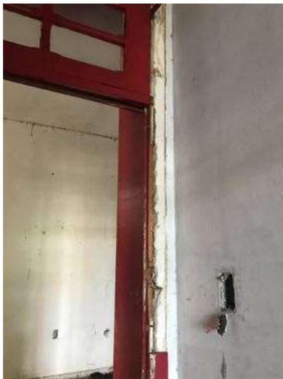
Figura 172: Marco de porta danificado. Fonte: FROS, C.S (2022).
