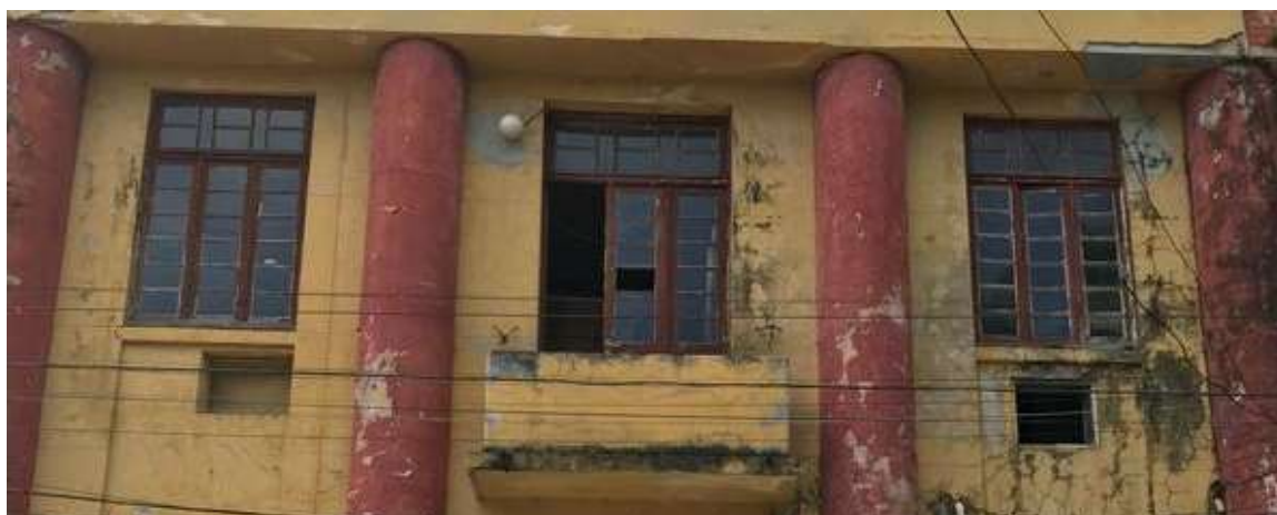
Figura 103: Ao centro, porta em madeira e sacada em balanço. Segmentando a fachada, há a adição de falsas colunas. No peitoril de duas esquadrias, vê-se volumes subtraídos para a instalação de antigos condicionadores de ar.
