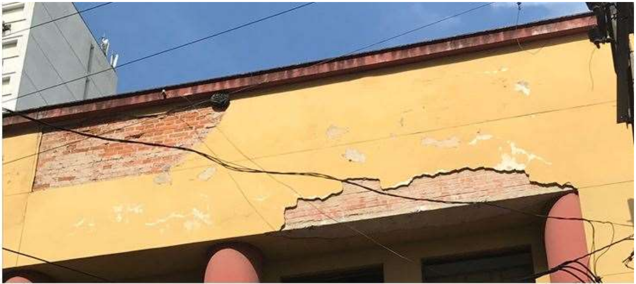
Figura 160: Na fachada voltada à Rua Roque Callage, destacasse, na platibanda, o desprendimento do reboco. Fonte: FROS, C.S (2021).
