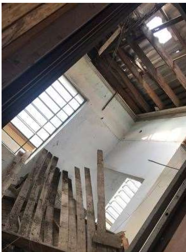
Figura 177: Telhado comprometido, visto desde o segundo pavimento. Destaca-se o desprendimento do forro. Fonte: FROS, C.S (2021).
