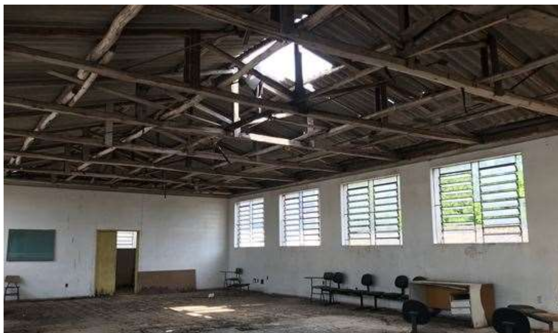
Figura 187: Quarto pavimento com o telhado danificado devido à falta de tela. Fonte: FROS, C.S (2021).
