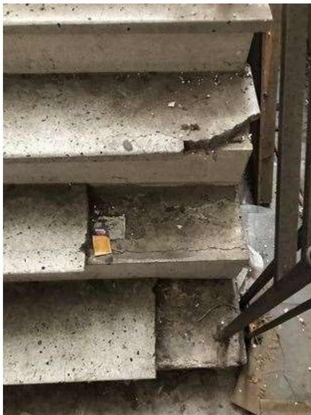
Figura 166: Primeiros degraus com peças quebradas. Correspondem à escada que comunica o primeiro pavimento com o segundo. Fonte: FROS, C.S (2021).
