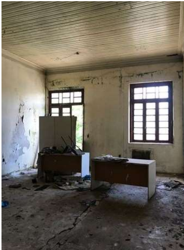
Figura 74: Ambiente voltado à Praça Saldanha Marinho. A porta à esquerda acessa a única sacada do imóvel. Destaca-se uma importante rachadura na laje. Fonte: FROS, C.S (2022).
