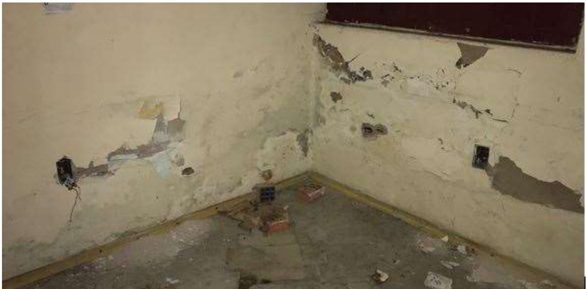
Figura 165: Presença de sais devido à umidade na base das paredes. Fonte: FROS, C.S (2021).
