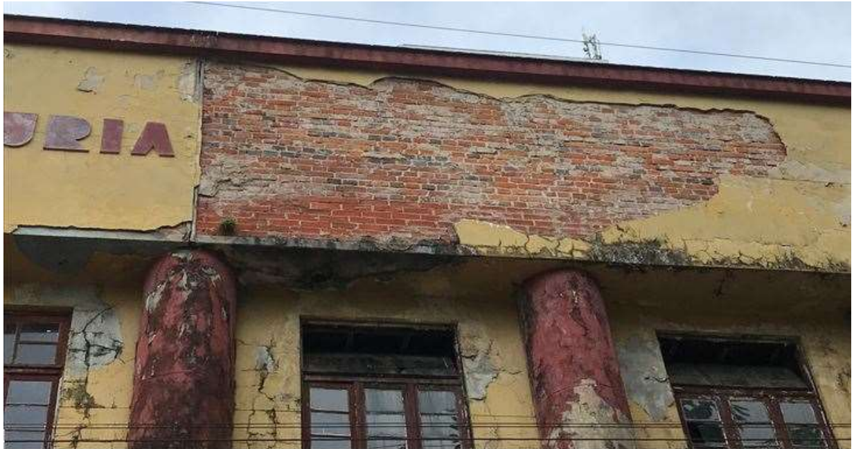
Figura 158: Em uma imagem mais próxima, destaca-se o despreendimento do reboco, assim como presença de vegetação e microrganismos. Fonte: FROS, C.S (2021).
