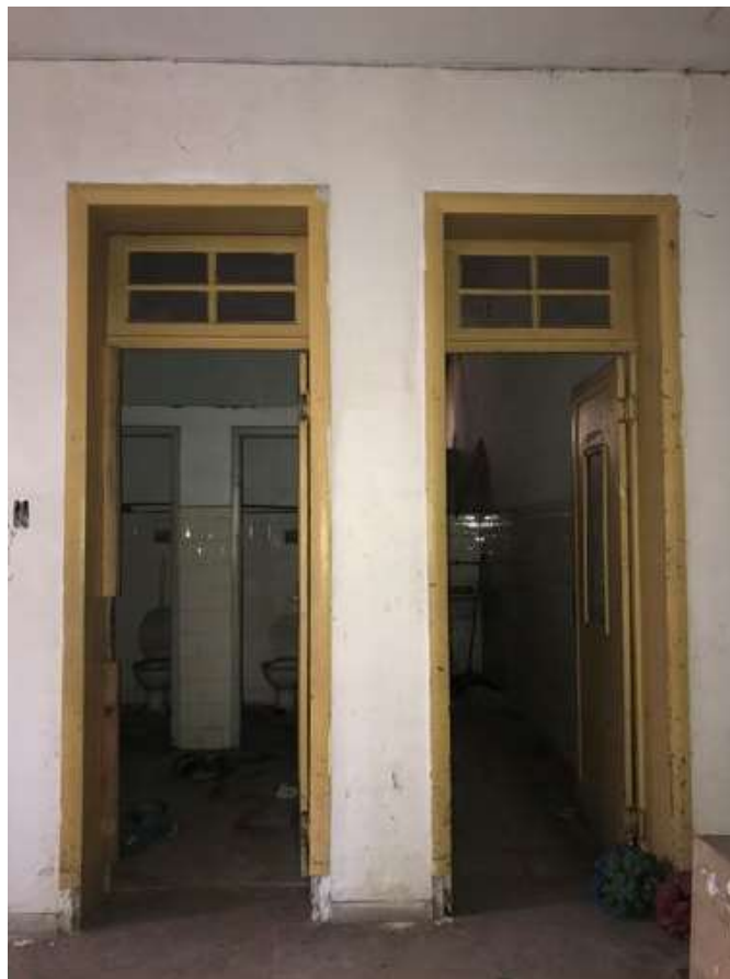
Figura 56: Desde o corredor, vista das portas de acesso aos antigos banheiros. Fonte: FROS, C.S (2022).
