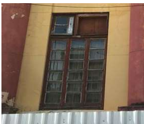
Figura 114: Janela de madeira com bandeira, três folhas e caixilhos com vidro. Identificada em desenho técnico como JE1f. Vê-se recorte em bandeira, devido à instalação de ar-condicionado.
